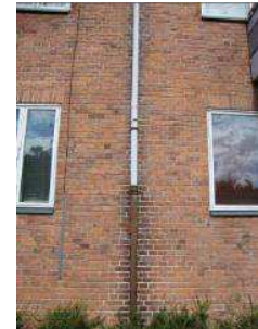
På murværket kan det flere steder ses, at der har været utætheder gennem tiden. Disse bør undgås ved jævnligt tilsyn med tagnedløbene.
