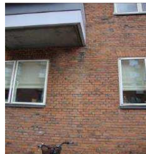
På murværk ved siden af/under altanerne ses tydelig markering af gentagen vandpåvirkning af facaden. Løsning på udbedring bør overvejes.
