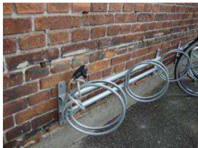
Murværk bag cykelstativer er flere steder i ringe kosmetisk forfatning. Gamle plugs m.v. bør fjernes, og fuger samt mursten eftergås.
