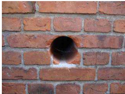
Ligeledes eksempel hvor der mangler rist i facaden, Strandlodsvej.
