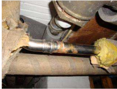
Ligeledes rør som mangler isolering.
