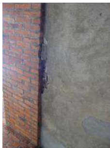
Her er ligeledes løse pudsområder ved overgangen til murværk (loftet i portrum på Milanogården).
