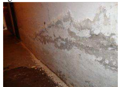
Fugt trænger højt op i væggene flere steder.
