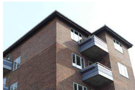
Ved Venedigvej 13, 4.sal, hvor der tidligere var udfordringer med fugt i murværk, er murværk omfugget og fremstår i god stand.
