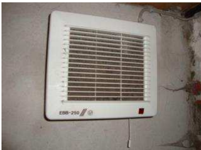
Mekanisk ventilering af vaske- og tørrerum (se også afsnit 02).
