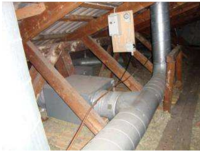
Ventilationsanlæg Palermovej 19 - er omtalt under ventilation.
