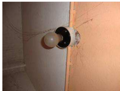
Belysning på gårdtoilet mangler kuppel.
