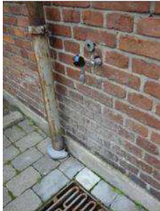
Der er flere udvendige vandinstallationer. (Her Milanogården)
