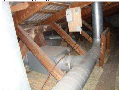
Udsugningsanlæg i Palermovej 19.
