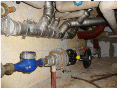
Eksempel på vandmåler i kælder.
