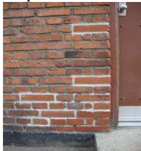
Ved udskiftning af mursten og eftergang af fuger, skal det i videst muligt omfang sikres, at samme fugemateriale anvendes.
