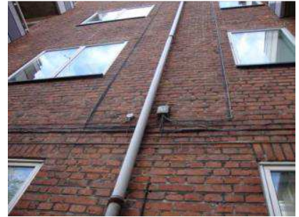
Tagnedløb er udført i plast og er i delvis dårlig stand. Disse bør eftergås, og enkelte bør skiftes.
