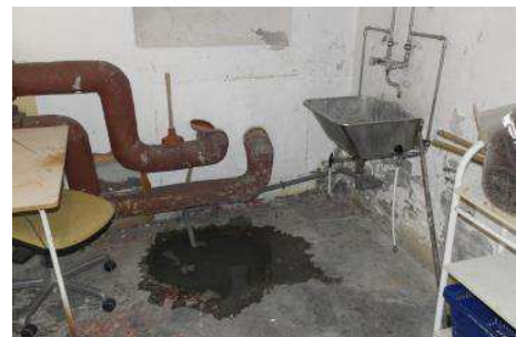
Afløb ved den ene varmecentral er forstoppet og skal renses.
