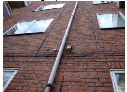
Gamle til installationer m.v., som ikke længere anvendes, bør fjernes fra facaden.
