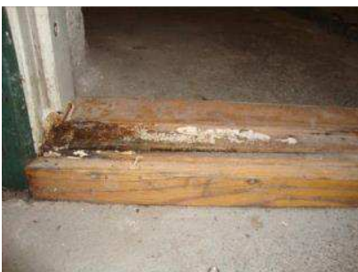
Svampeangreb på kælderør samt meget ildelugtende rum omkring Korsikavej 8. Dette skal undersøges nærmere og udbedres. Der skal samtidigt etableres bedre ventilation. Svampvæksten er mindre i 2016.
