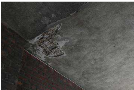
Pudsafskalninger i loftet i portrummet har arealer, hvor det er defekt og bør udbedres. (Milanogården)
