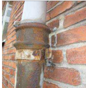
Fastgørelsen at tagnedløb bør eftergås.
