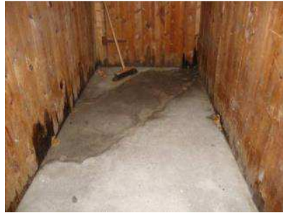
Fugt trænger i visse tilfælde op i træværk til kælderrummene. Hvis denne påvirkning fortsætter, vil der komme svamp. Kælderen er mere tør i 2016, end billedet fra 2011.
