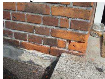
Ødelagt mursten grundet saltpåvirkning ved indgangsparti.
