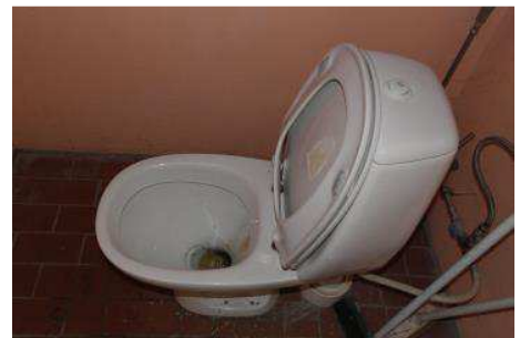
Meget lidt vand i toilet. Det bør undersøges, om der er forstoppelser i systemet.
