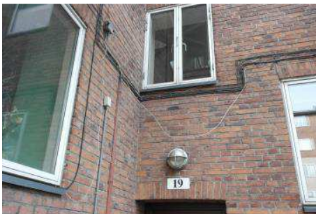
Flere installationer er ringe opsat på facaden.
