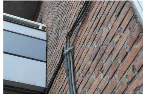
Gamle installationer bør demonteres, og installationer i brug bør fastgøres korrekt.
