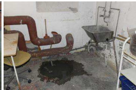
Her er forstoppet kloak ved den ene varmecentral. Den bør renses.
