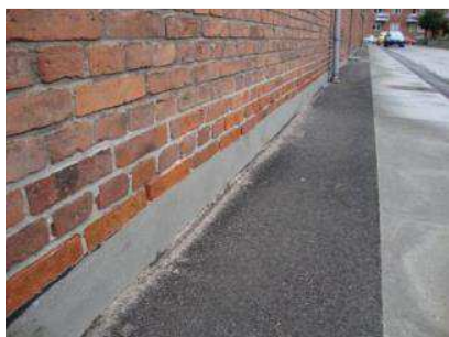
Nederste skifter er generelt meget ødelagt grundet høj saltpåvirkning. Se også afsnit 2.
