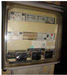
Det anbefales, at el-installatør gennemgår ejendommens tekniske installationer og tilser, at der er HFI eller HPFI-relæer i henhold til gældende regler.
