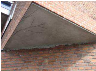
Dårligt udført støbearbejde. Kun kosmetisk betydning.
