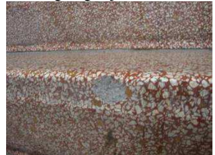
Trappeløb er terrazzo med nogle skader.
