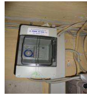
Ur til styring af installation (ikke identificeret ved gennemgangen).
