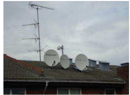
Antenne og paraboler er i følge oplysninger ikke længere i brug. Såfremt dette er korrekt, bør de demonteres.
