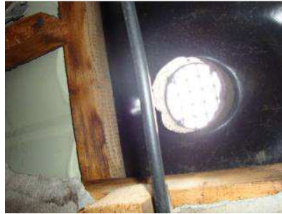
En taghætte for ventilering af tag mangler og skal genmonteres. (Venedigvej)
