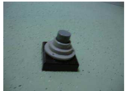
Installationer, som ikke er i brug på trappeopgange, burde være fjernet.
