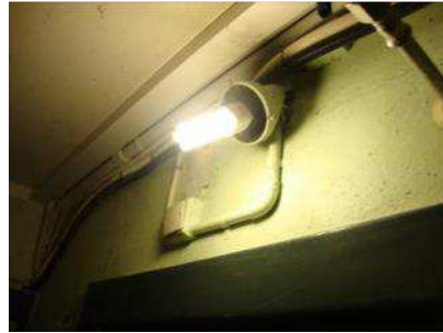
Belysning i kælderen anbefales udskiftet i henhold til EMO-rapport.
