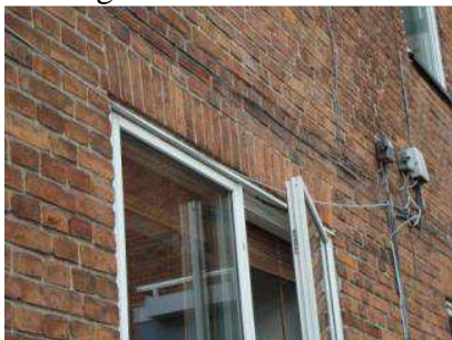
Løst kabel over vindue bør fastgøres korrekt, såfremt det er i brug.
