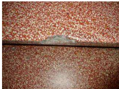
Trappforkanter har nogle skader efter ind og udflytninger i ejendommen.
