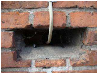
Riste i facaden mangler flere steder. Her eksempel fra Strandlodsvej.
