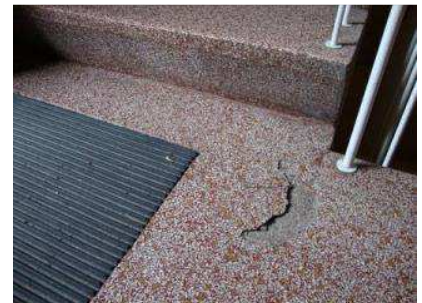
Enkelte steder, som her Palermovej 19, er terrazzoen revnet/afskallet og bør udbedres.
