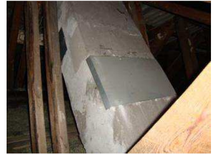
Aftrækskanal fra naturlig ventilation.
