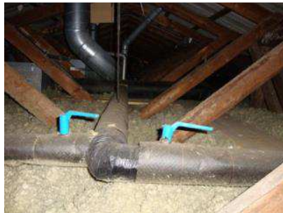
Rørinstallation i tagrum er godt isoleret.
