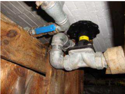
Flere rør som ikke er isoleret.
