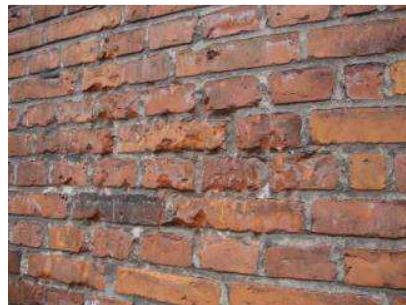
Ødelaget mursten i containergården på Korsikagården.
