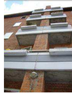
En del skjolder under betonbunden. Det bør ved regnvejr observeres, hvordan vandet kommer på undersiden af altanerne. Det skal sikres, at vand ikke kommer gennem betonen.
