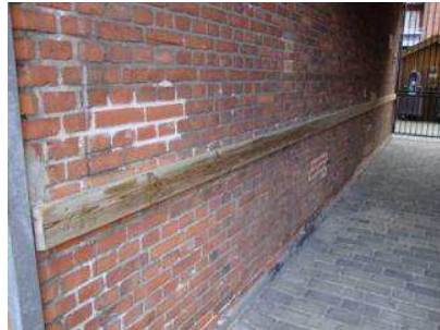
I den ene side er etableret fender som værn. Denne løsning er bedre end blot at udskifte mursten.
