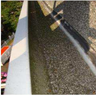
En del Decra-overflade i tagrenden kunne tyde på, at det er længe siden tagrender er rensset. Bør gøres jævnligt sammen med inspektion at tag m.v.
