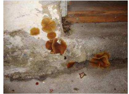
Svampeangreb på både træværk og murværk. Her ses svampe i kælderen Korsikagården. Dette foto er fra 2011, og ikke observeret i 2016.
