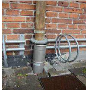
Tagnedløb og overgange til sandfang er i varierende stand.
