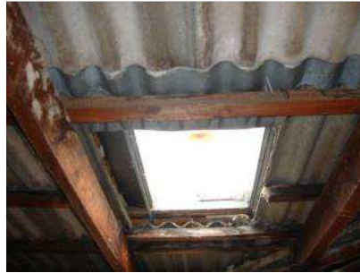
Tagvinduer syner generelt i god stand. Det var vanskeligt at komme til flere vinduer grundet manglende gangbroer.
