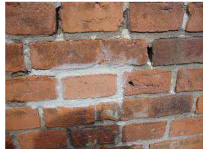
Her ses manglende studsfuger samt dårlig reparation af mursten.
