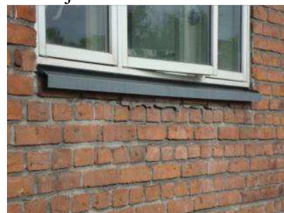
Fuge under vindue er i ringe stand og bør udskiftes. Milanogården.
