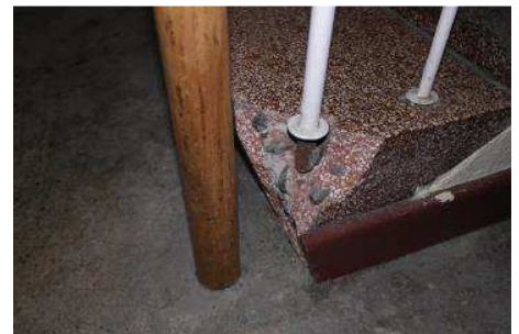
Terrazzoen har flere skader, som bør udbedres.
