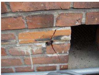
Eksempel på ødelagte mursten, som bør skiftes.
