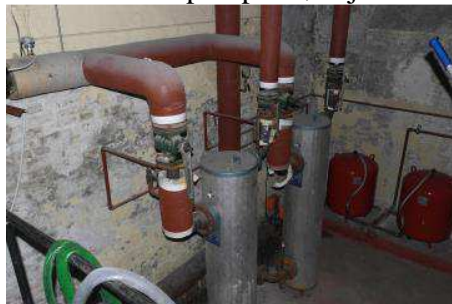
Årlig rensning af varmevekslere anbefales.
