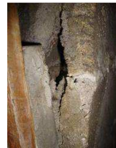
Naturlige aftrækskanaler er mange steder konstateret utætte med risiko for fugt i tagrum til følge. Skal udbedres.
