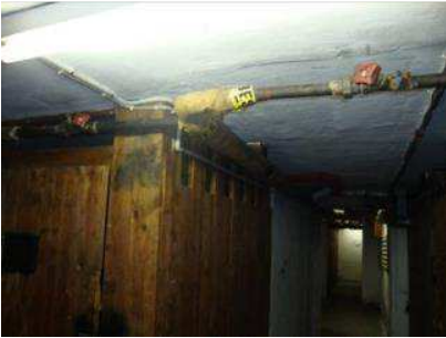
Mange varmerør i kælderen mangler isolering.
