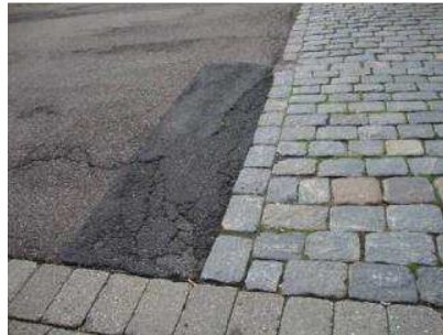
Her ses mindre reparation i asfaltbelægningen.
