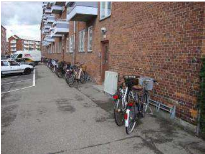
Belægninger mod Venedigvej er asfalt. Her er mindre krakeleringer, men holder nogle år endnu.
