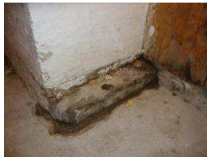
Opfugtede sokler i kælder (flere steder). Dette foto er fra 2011 og ikke observeret i 2016.
