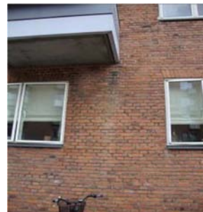
På murværk ved siden af/under altanerne ses tydelig markering af gentagende vandpåvirkning af facaden. Løsning på udbedring bør overvejes.
