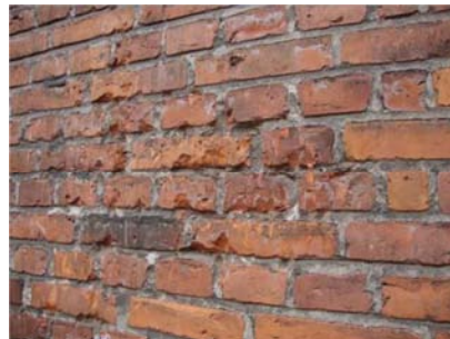
Ødelaget mursten i containergården på Korsikagården.
