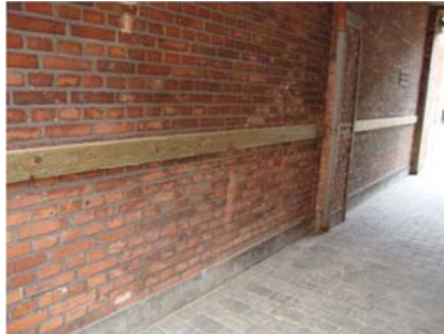
Her er ligeledes monteret fender på murværk for at afværge de værste skader fra containerne.
