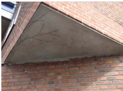
Dårligt udført støbearbejde. Kun kosmetisk betydning.
