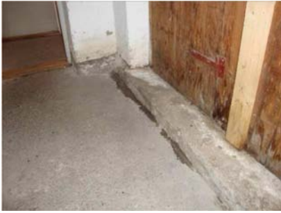
Kælder ved Venedigvej er ligeledes fugtig, dog ikke i samme grad som vist på forrige foto.
