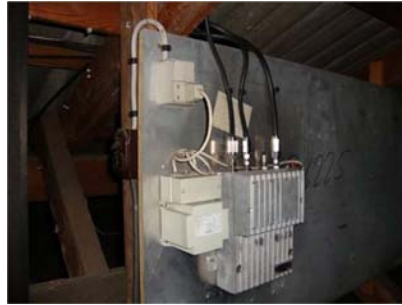
Ældre anlæg som muligvis ikke længere er i brug. Såfremt det ikke anvendes, bør det demonteres.
