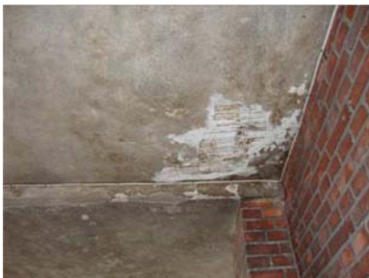
Pudsafskalninger i loftet i portrummet har arealer, hvor det er defekt og bør udbedres. (Milanogården)
