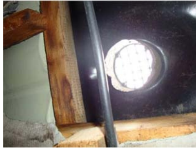
En taghætte for ventilering af tag mangler og skal genmonteres.
