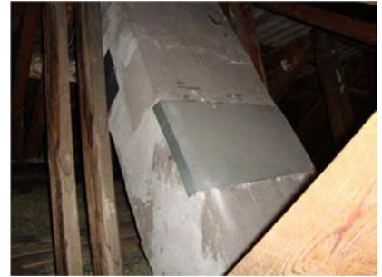
Aftrækskanal fra naturlig ventilation.
