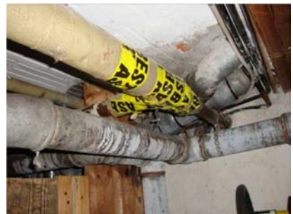
Her er mærkater med asbest. Der skal tages højde for asbest, når rør skal efterisoleres.
