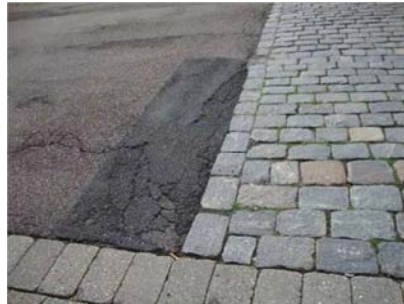
Her ses mindre reparation i asfaltbelægningen.
