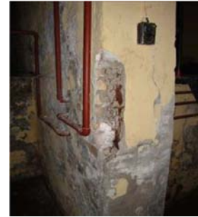
Der er 1 fyrekælder i hver ejendom. De er renoveret for ca. 30 år siden. Her eksempel på behov for nogen vedligeholdelse.
