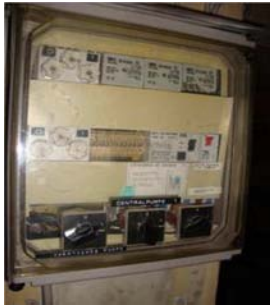
Det anbefales, at el-installatør gennemgår ejendommenes tekniske installationer og tilser, at der er HFI eller HPFI-relæer i henhold til gældende regler.
