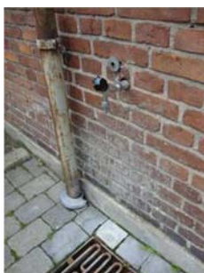
Der er flere udvendige vandinstallationer. (Her Milanogården)
