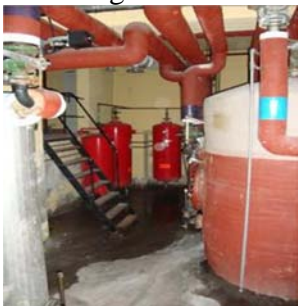
Her er jævnligt oversvømmelser i henhold til viceværten. Højt vandslukke i gulvafløb anbefales.
