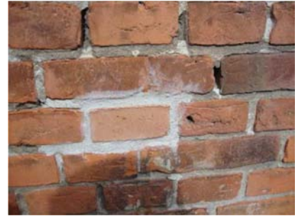
Her ses manglende studsfuger samt dårlig reparation af mursten.
