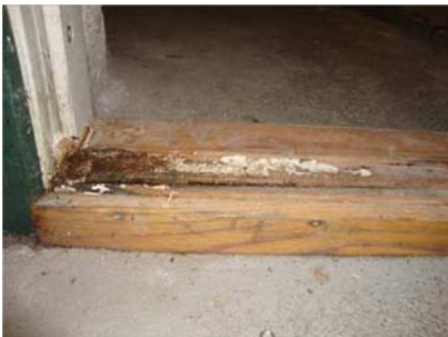
Svampeangreb på kælderør, samt meget ildelugtende rum omkring Korsikavej 8. Dette skal undersøges nærmere og udbedres. Der skal samtidigt etableres bedre ventilation.
