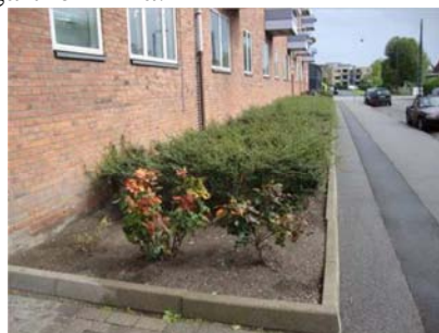
Ligeledes bed ved Korsikagården ud mod Palermovej. Kantsten buler lidt, men i acceptabel stand.
