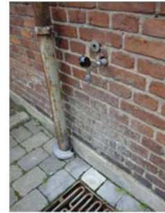
Udvendig vandhane med tilhørende kloakrist.
