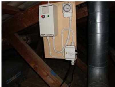
Automatik for udsugning fra Palermovej 19.
