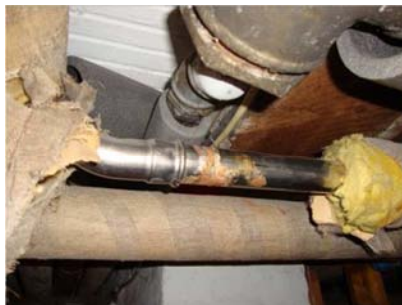
Ligeledes rør som mangler isolering.
