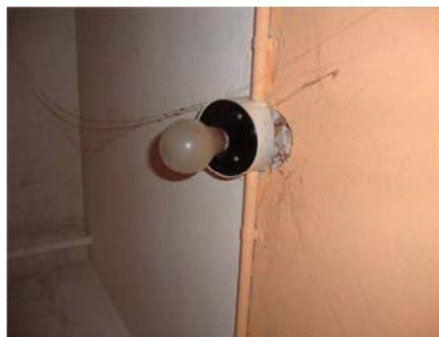
Belysning på gårdtoilet mangler kuppel.
