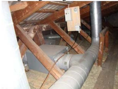
Udsugningsanlæg i Palermovej 19.
