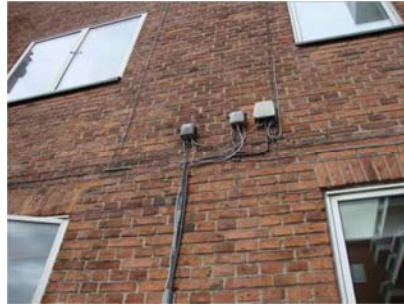
Gamle installationer på facader som ikke længere er i brug bør fjernes (er med i afsnit 03)
