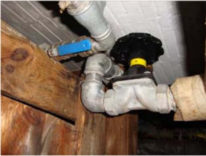
Flere rør som ikke er isoleret.
