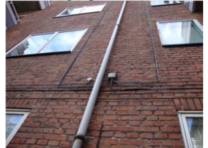
Gamle til installationer m.v. som ikke længere anvendes, bør fjernes fra facaden.
