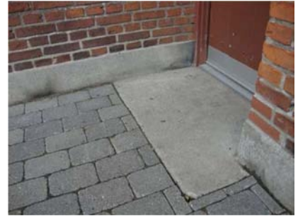
Belægninger ved Palermovej 19 synes som om der er lidt bagfald (meget ringe fald). Såfremt det er et problem, må løsning findes.
