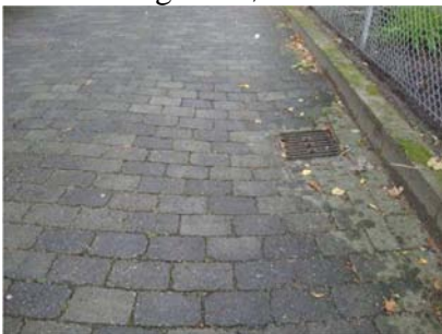
Belægninger er generelt pæne, jævne, hvorfor det formodes at kloakker ikke er utætte.
