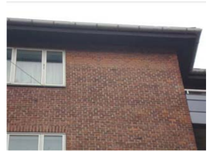
Ved Venedigvej 13, er der målt partielt højere fugt i områder på indvendig side af væg. Dette skyldes ødelagte studsfiger samt forvitret overflade af mursten.
