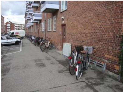
Belægninger mod Venedigvej er asfalt. Her er mindre krakeleringer, men holder nogle år endnu.
