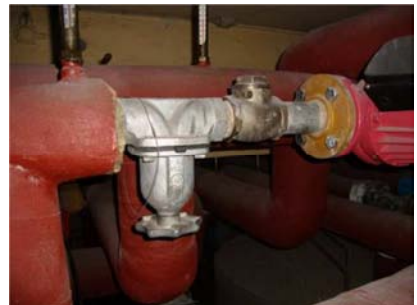
Nærbillede af ventil som ikke er isoleret.
