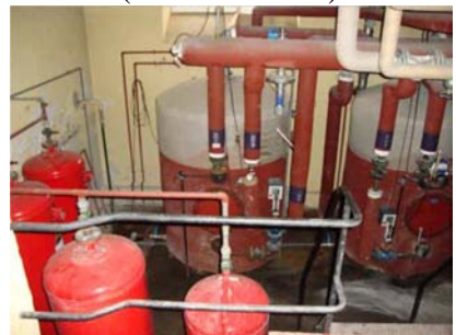
Varmtvandsbeholdere er fra 1981.
