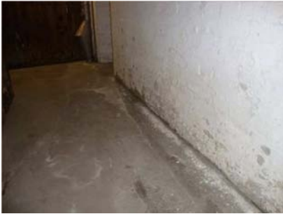
Ved kraftigt regnvejr er det oplyst fra viceværten, at der på dette sted (kælder Palermovej 19) kommer meget vand ind. Årsag skal undersøges nærmere. Grundet høj fugtighed i gulv og væg, kan årsagen være utæt kloak under gulv på dette sted.
