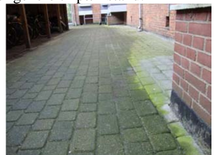
Belægninger er generelt i god stand. Belægninger bør holdes frie for alger.
