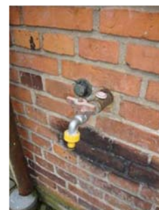
Her er ligeledes udvendig vandinstallation.
