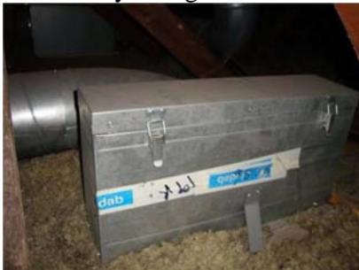
Centralt udsug i opgang Palermovej 19. Dette anbefales i alle opgange.
