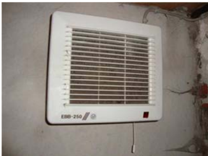
Mekanisk ventilering af vaske- og tørrerum.
