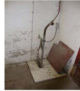
Pumpesump i Milanogården. Det skal undersøges, om denne er i funktion samt overvejes om der skal etableres yderligere så fugten fra kældergulvene kan minimeres.
