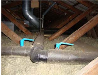
Rørinstallation i tagrum er godt isoleret.
