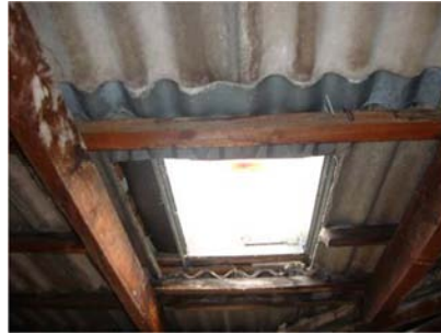
Tagvinduer synes generelt i god stand. Det var vanskeligt at komme til flere vinduer grundet manglende gangbroer.
