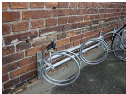
Murværk bag cykelstativer er flere steder i ringe kosmetisk forfatning. Gamle plugs m.v. bør fjernes og fuger samt mursten eftergås.
