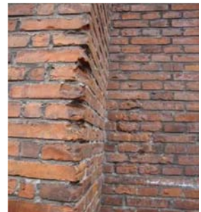
Ligeledes ødelagte mursten i forbindelse med containergården på Korsikagården.
