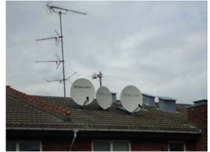
Antenne og paraboler er i følge oplysninger ikke længere i brug. Såfremt dette er korrekt, bør de demonteres.
