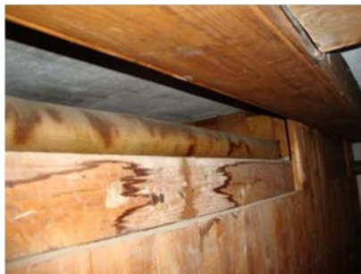
Her er skjolder efter tidligere utætheder på installationerne, men der er ikke konstateret nogen utætheder på gennemgangen.
