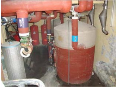
Der er 1 boilerum i hver ejendom. Afmærkninger på diverse fremtræder overskueligt.
