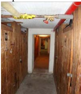
Mange installationer i kælder mangler isolering. Der er muligvis konstateret asbest. Her ses eksempel på bånd med navnet asbest på mange af rørene.
