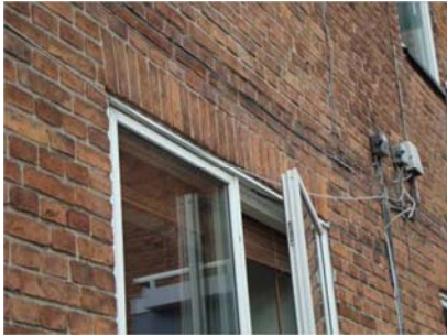
Løst kabel over vindue bør fastgøres korrekt såfremt at det er i brug.
