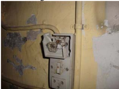
Defekt kontakt skal skiftes.
