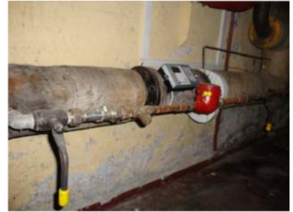
Flere rør og ventiler mangler isolering. Her ses lille rør som ikke er isoleret (foran det store).
