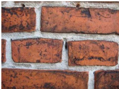
Dårlige studsfiger bør udbedres.
