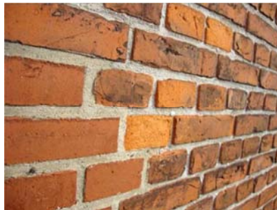
Eksempel på ødelagt overflade af mursten, som bør skiftes.
