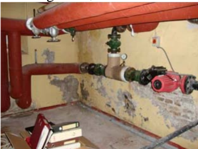
Flere ventiler m.v. mangler isolering.
