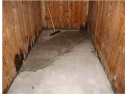
Fugt trænger i visse tilfælde op i træværk til kælderrummene. Hvis denne påvirkning fortsætter vil der komme svamp.
