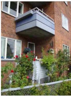
Terrasse i stueplan er i ringe stand. Det vil pynte, hvis den fik samme sidebeklædning som altanerne.
