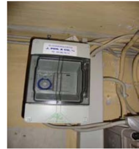
Ur til styring af installation (ikke identificeret ved gennemgangen).
