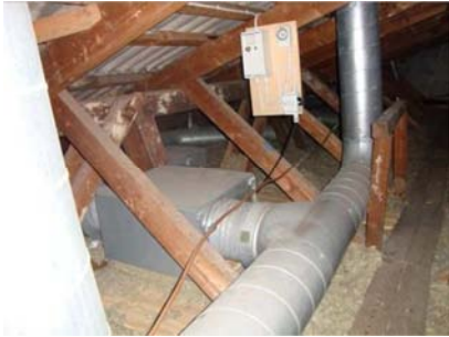
Ventilationsanlæg Palermovej 19, er omtalt under ventilation.
