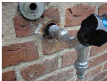
Gammel installation bør fjernes.
