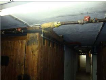
Mange varmerør i kælderen mangler isolering.
