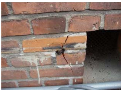
Eksempel på ødelagte mursten som bør skiftes.
